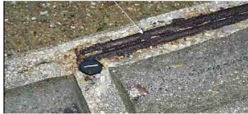
Fig. 1.6: Une épaufure sur un pylône EDF
