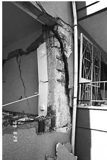
Fig. 2.1: Bâtiment fissuré par le séisme d'Izmit (Turquie, août 1999)
