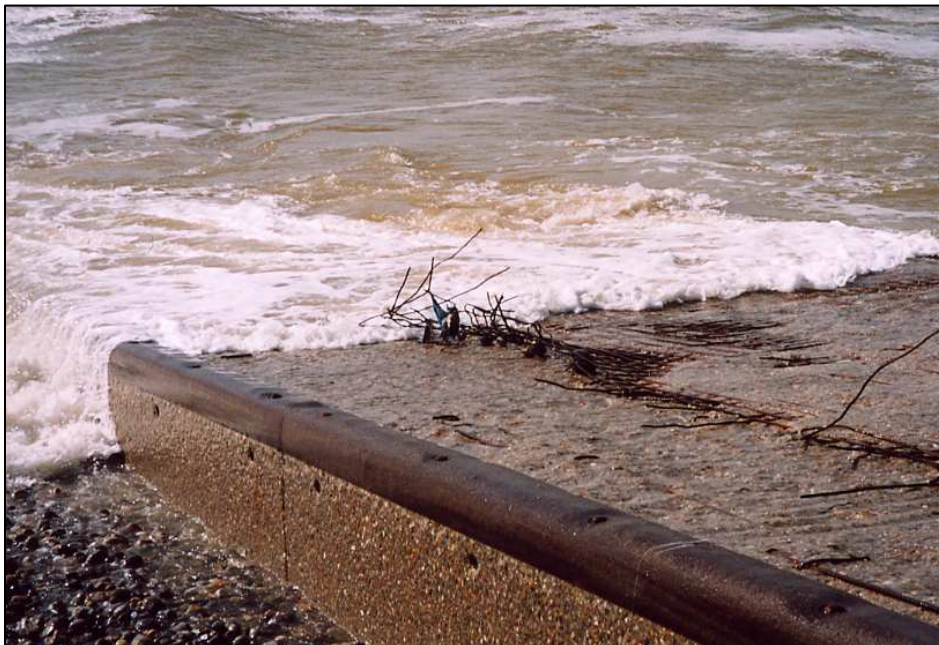
Photo 55 : vulnérabilité des épis en béton armé face aux assauts des vagues qui projettent des galets. Il s'agit ici de l'épi le plus récent (1998), situé au niveau de l'amer sud de Cayeux-sur-mer. Les tiges métalliques sont découvertes par l'usure du béton. Cette situation pose la question de la longévité de ce mode de protection, et donc de son efficacité (Cliché pris en 2003 in Bawedin, 2007).
