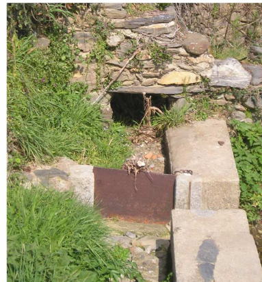
Ouvrage de transversement équipé de vanne sur un "petit canal" de Rigarda (cliché : Riaux, avril 2004)
