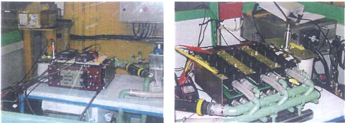
Figure I-60 : Bras d'onduleur 3 x 3.3 kV HIPO
