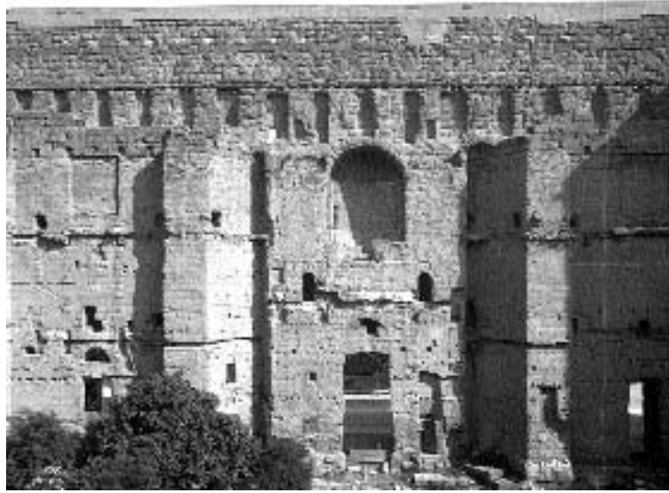
Fig. 524 a. Le mur de scène du théâtre d'Orange avant toute reconstitution de son ornementation. (Phot. C.N.M.H., lp010286.)
