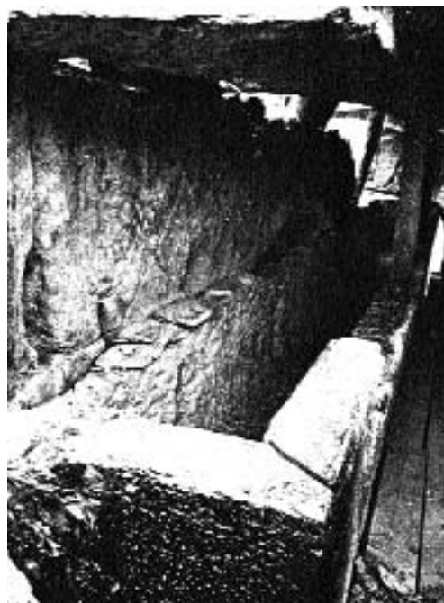
Fig. 333. Linteau de la galerie du second niveau à Nîmes évidé pour accueillir une poutre en ciment armé sur la hauteur de deux linteaux. (Phot. A. Chauvel, M.H.F., 1938.)
