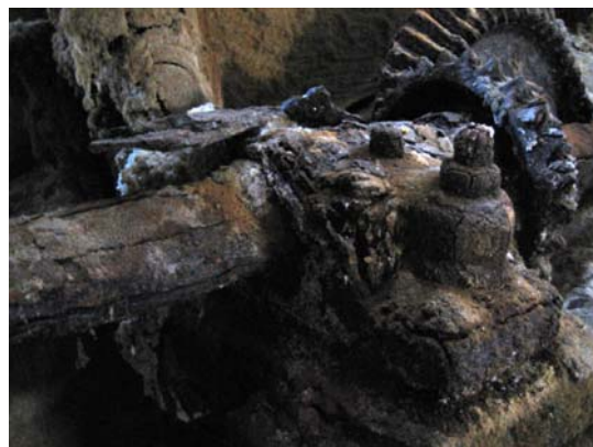
Figure 164 : PHOTO, PALIER ET AXE DEFORMES
