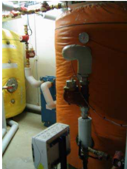
Figure 87 : Ballons de stockage
