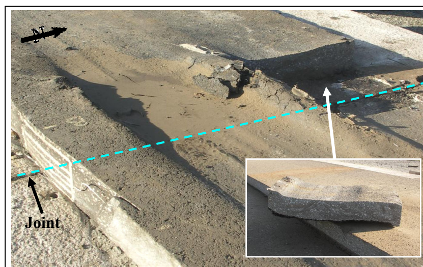
Figure 2.40 – Orniérage et fluage latéral de la couche de sable bitume – joint N° 2
