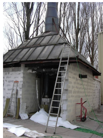
(b) Hotte munie du dispositif de soufflage mis en place pour les essais 3 à 6
