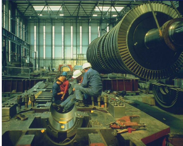
Figure 7.1.1 : Rotor et directrices HP de la centrale de Bugey.
