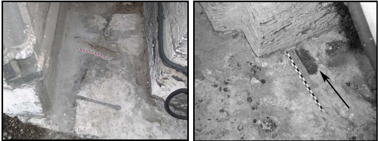
Figure 111 : Agrafes au sol du 2 e étage de la tour de la croisée de l'église Saint-Ouen.
