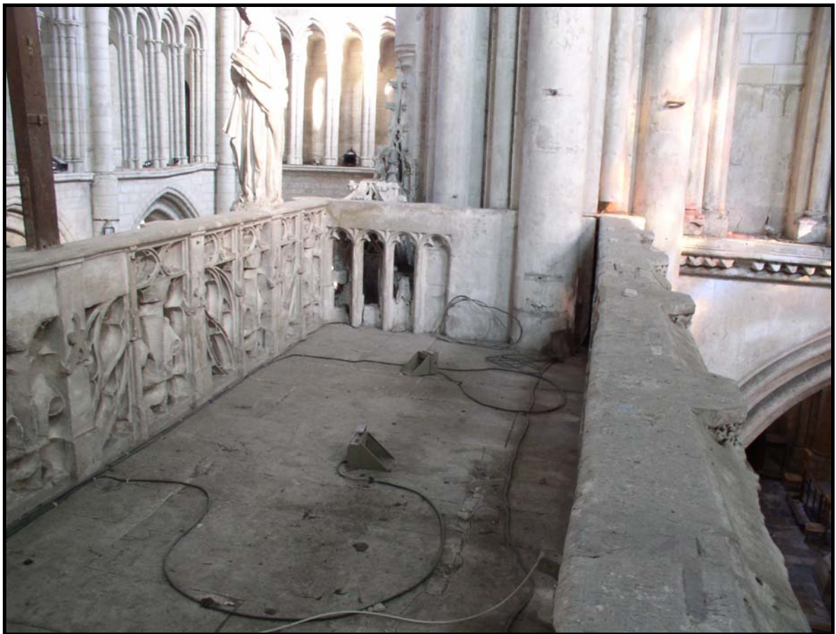
Figure 256 : Balustrade supérieure du jubé de l'église Sainte-Madeleine de Troyes avec empreinte d'agrafes.
