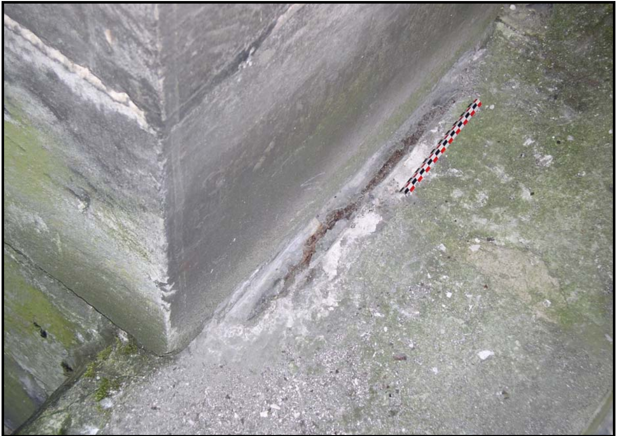
Figure 89 : Agrafes de la coursiue des fenêtrés hautes du chœur de l'église Saint-Ouen de Rouen. En bas, agrafe longeant la maçonnerie de l'arc-boutant.
