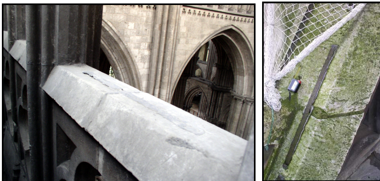
Figure 55 : Agrafes au portail de la Calende. A gauche, au revers, sur la balustrade à hauteur du triforium ; à droite, agrafe du gâble.
