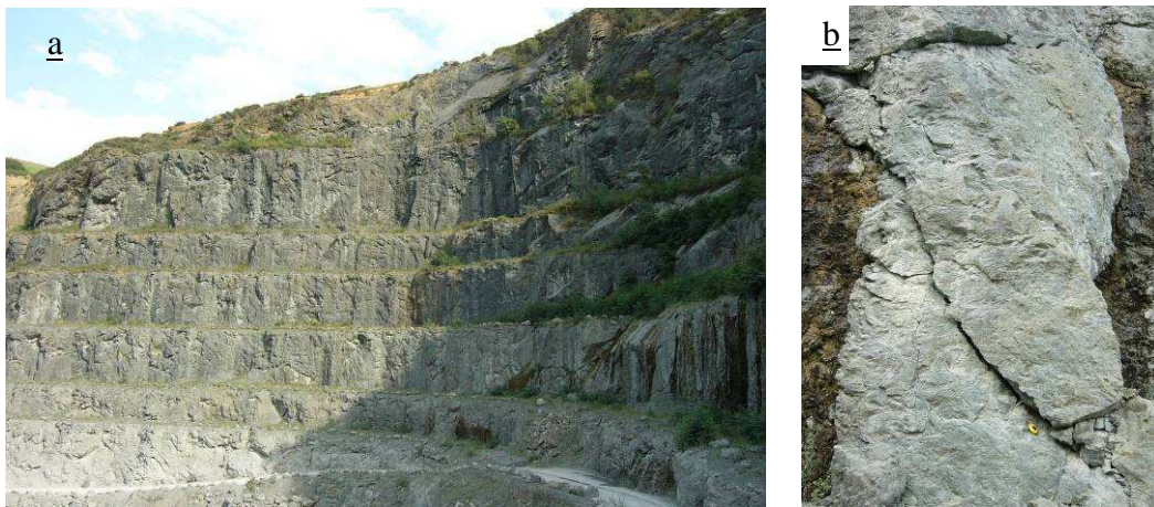
Figure 1.40 (a) Photographie du talus sud de la carrière d'ophite de Souraïde, (b) un grand bloc, délimité par les joints, potentiellement amovible et dangereux.
