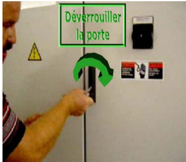
Figure 4. 15. Exemple d'une augmentation montrant au technicien comment déverrouiller la porte
