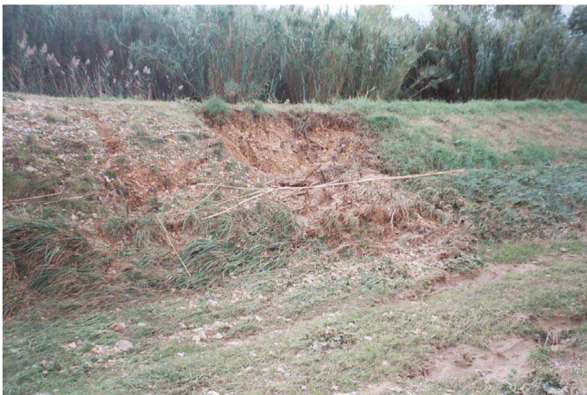
Photographie 3.3 : Fragilisation des digues bordières de l'Aude (F. Vinet, nov. 2005) Ce secteur de digue, réparé à la hâte en 1999, a été fragilisé par les fortes pluies de novembre 2005.
