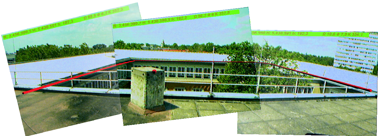
Abbildung 6.14: Bilder zur Überlagerung einer aufgenommenen Dachrinne; die rote Linie wurde durch in die reale Szene skizziert. Die rote Kugel ist eine virtuelle Repräsentation der Koordinaten der Mitte der Betonsäule.
