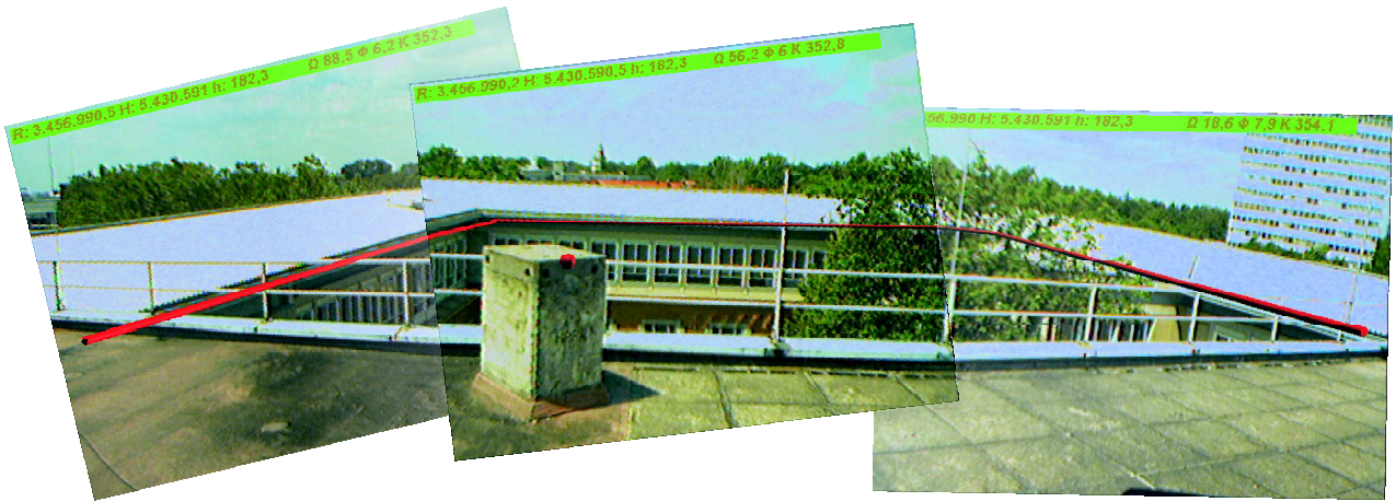
Abbildung 3: A l'aide du seul système RTK, la gouttière dessinée en rouge ne pourrait pas être mesurée.
