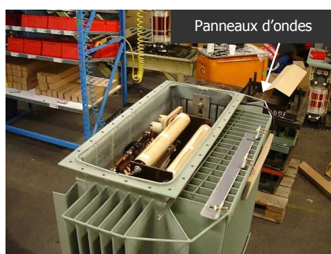
Figure 38. Cuve de transformateur équipée des panneaux d'ondes
