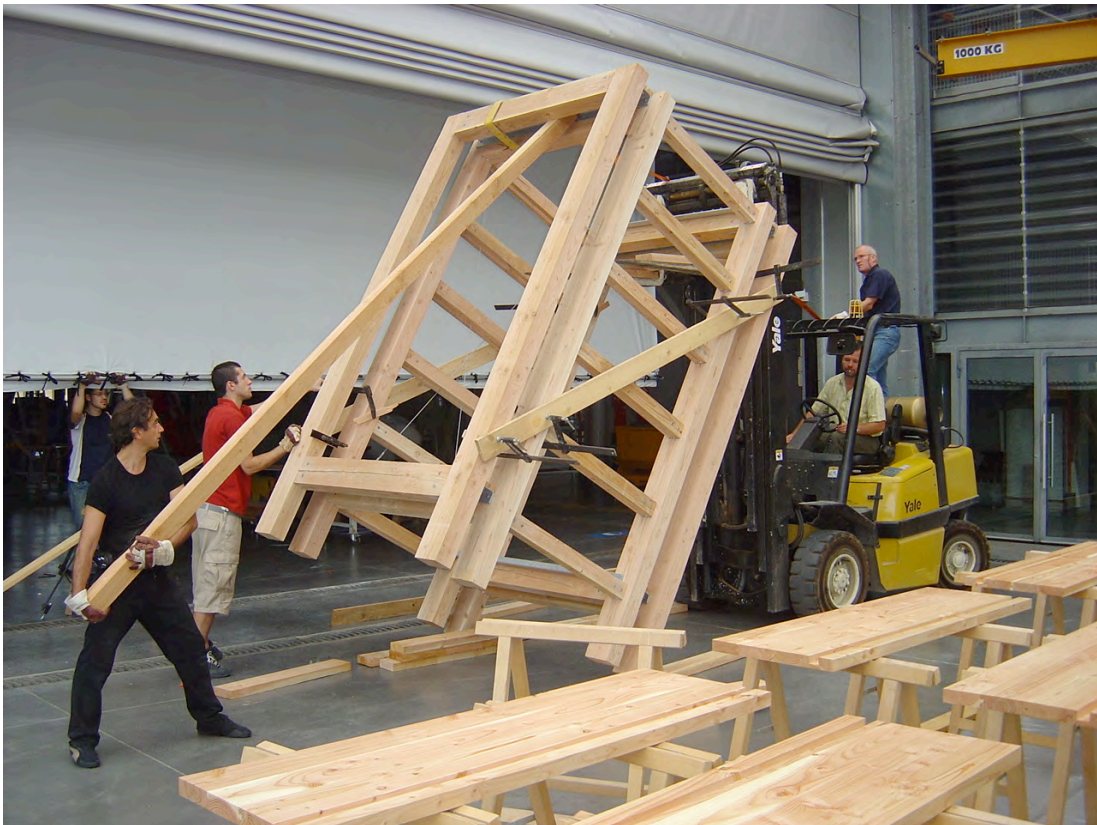
Expérimentation à échelle 1 aux Grands Ateliers de l'Isle d'Abeau. Construction du prototype. Lipsky-Rollet architectes. Document fourni par l'architecte.
