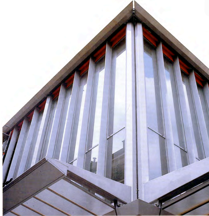
Photo N° 2 (annexe 16) : Maison du peuple à Clichy. Façade de la galerie marchande avec marquise. Etat en 1998, après restauration. Marcel Lods, architecte. (Sulzer, 2000)
