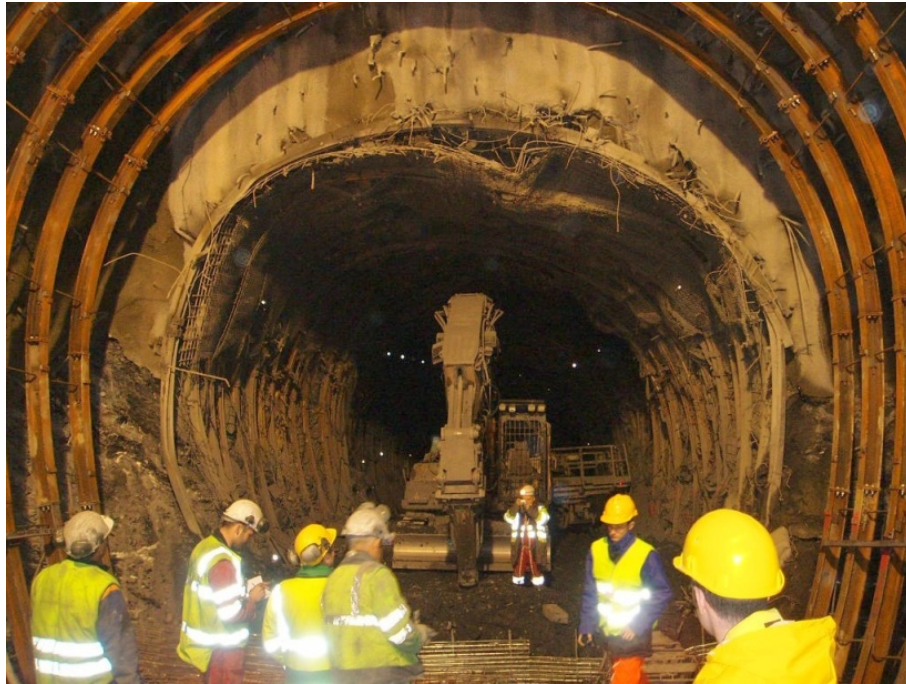
Fig. 1.10 – Déformations de la descenderie de St-Martin-la-Porte sur le projet Lyon-Turin (photo Cetu-LTF / PM 1270 / mars 2006).
