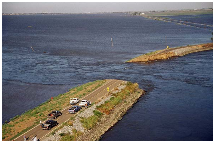
Figure 47: Effondrement inexpliqué de la Jones Tract Levee en 2004.
