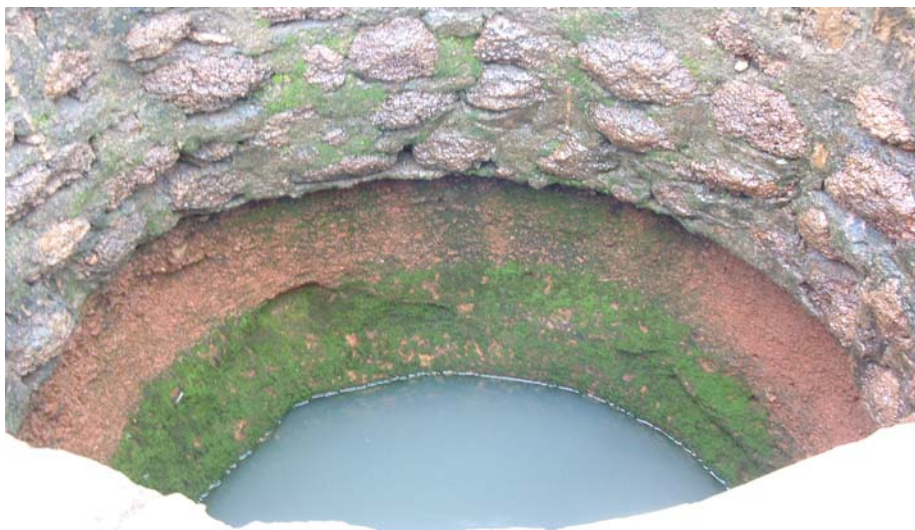
Figure 63 : Exemple d'un puits villageois largement ouvert et mal entretenu (Pamido, juillet 2003).
