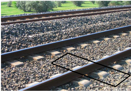
Figure 2.3: Voie ballastée réelle. En trait noir on représente la portion de voie qui sera modélisée.
