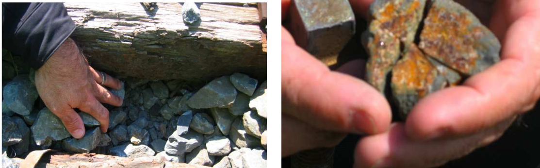
Figure 2.48: Grains de ballast brisés et état du ballast sous le blochet suit au passage de la bourreuse. Photographie prise lors d'une opération de maintenance près de Nîmes. Dans ce cas, la fréquence de vibration des bourroirs est de 35 Hz.
