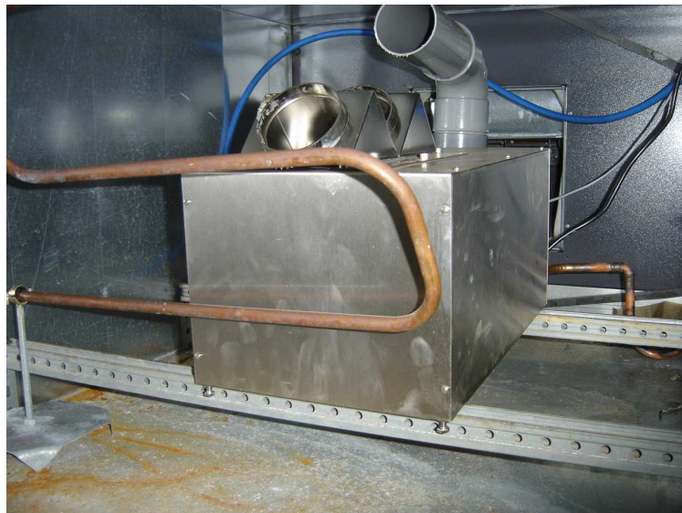
Figure 4. 23 : Tube en U placé devant l'humidificateur dans la gaine de soufflage.
