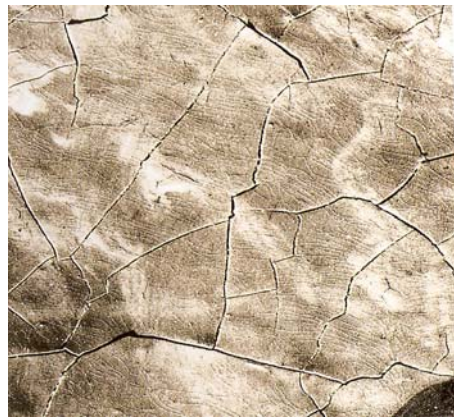
Figure 1 : exemple de faïençage d'une couche de vernis (photo [21] )
