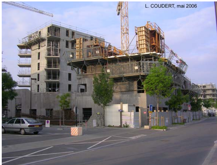
Photographie 44 – L'opération immobilière « Habiter les quais », quai François Mitterrand à côté du nouveau Palais de Justice.
