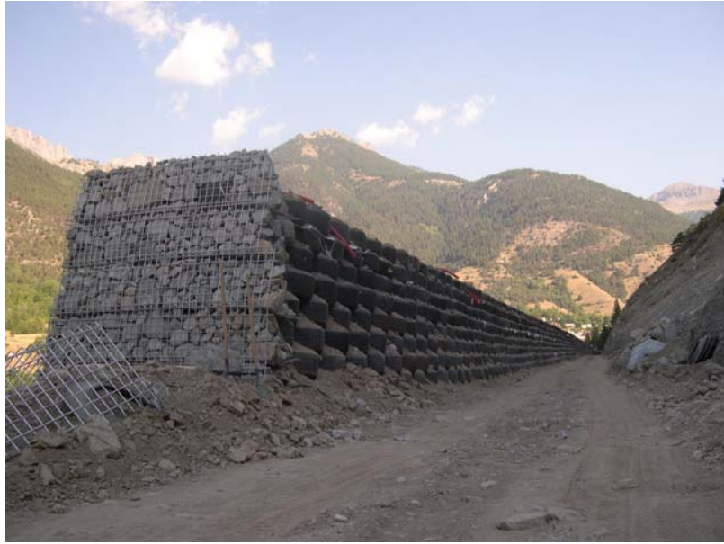
Figure I 8 : Merlon de protection renforcé par des pneus (IMS-RN)
