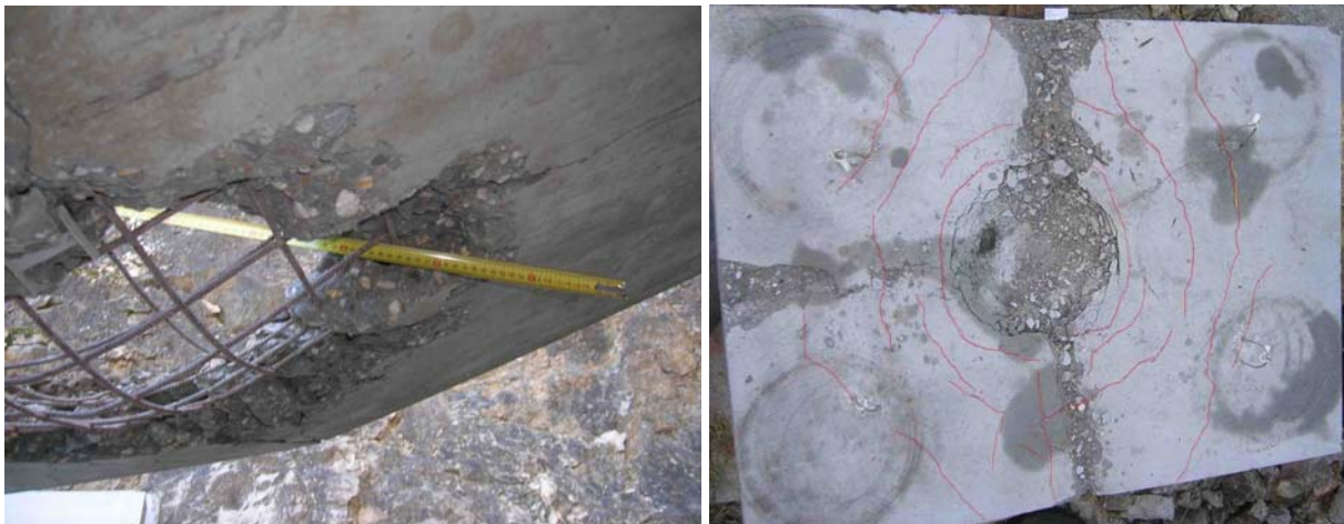
Figure III 26 : Vue de dessous de la zone impactée, Vue de dessus du réseau de fissures pour une énergie d'impact de 64 kJ
