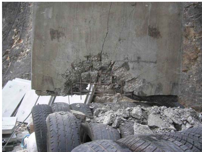
Figure III 28 : Endommagement de la dalle après deux impacts consécutifs à 32 kJ
