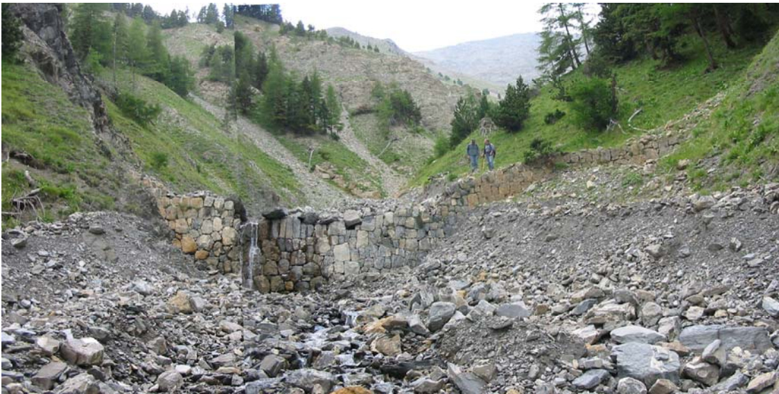
Id 90 n° 60+3 RTM n°64 Alt : 2127.6 Juillet 2004 Photo 88-89 Photos Seuils manquants Id 91 (60+4)
