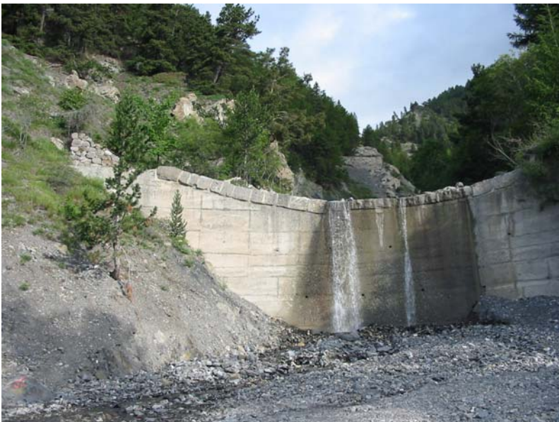
Id 68 n°41+14 RTM n°47 Alt : 1861.2 Juillet 2004 Photo 49 Photos Seuils manquants, Id 69 (SN12) et Id 70 (SN13)
