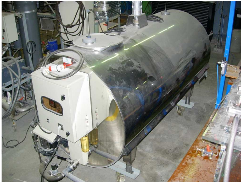
Figure 3.3 : Bassin de stockage de l'effluent.
