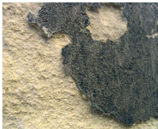
Figure I.6 : croûte noire se détachant et laissant le tuffeau pulvérulent (Tours)
