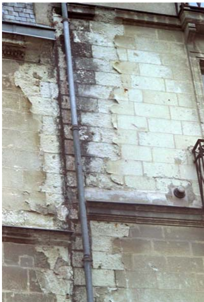
Figure I.15 : altération en plaques initiée par un apport d'eau particulier (Nantes)
