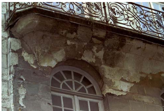
Figure I.5 : croûte noire formée sur un mur en tuffeau abrité des pluies fouettantes (Nantes)
