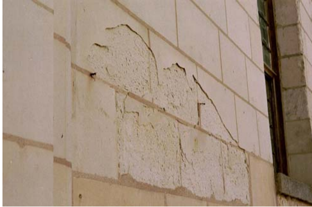
Figure I.17 : altération en plaques affectant tout un mur (château de Chambord)
