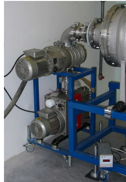
FIG. 3.22 – Groupe de pompage BOC Edwards
