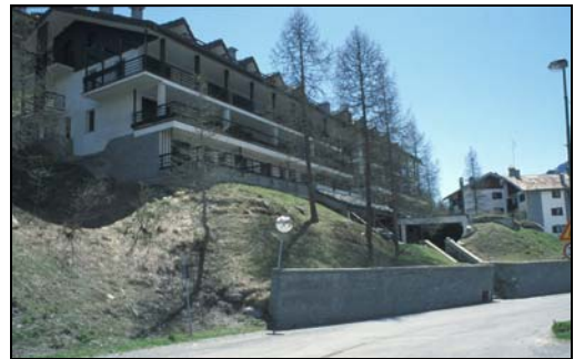
B. Cielo alto, résidence bâtie sur un glissement et déplacement du mur aval sous la poussée
