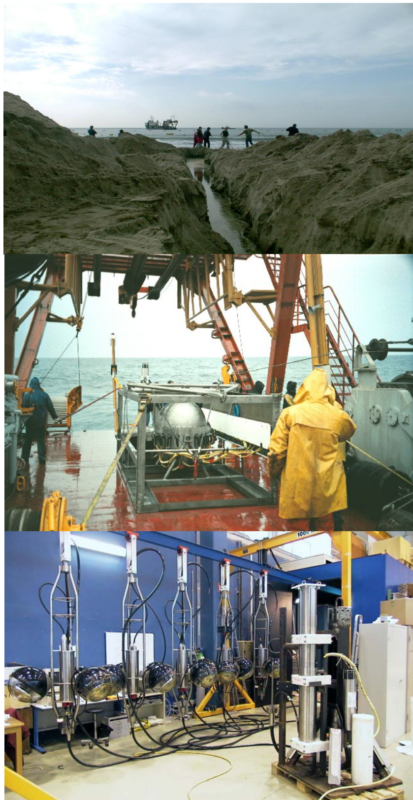
Fig. II.25 – Quelques photos de la mise en place du détecteur. En haut, enfouissement sur la plage des Sablettes à La Seyne-sur-Mer du câble électro-optique reliant le détecteur à la côte (10/11/01). Au milieu, Mise à l'eau de la boîte de jonction (9/12/02). En bas, photographie d'un secteur prototype qui fut ensuite immergé et testé dans les conditions réelles (04/11/02).
