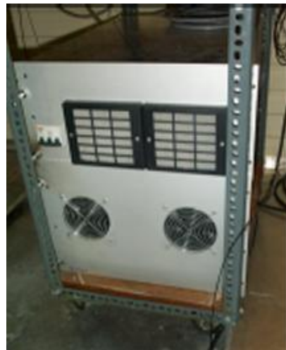
Figure II-5 : Alimentation haute tension de chez E.T.A.T.
