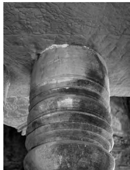
Ph. 684 : Balustre de fenêtre à Angkor Vat présentant des traces d'enduit
