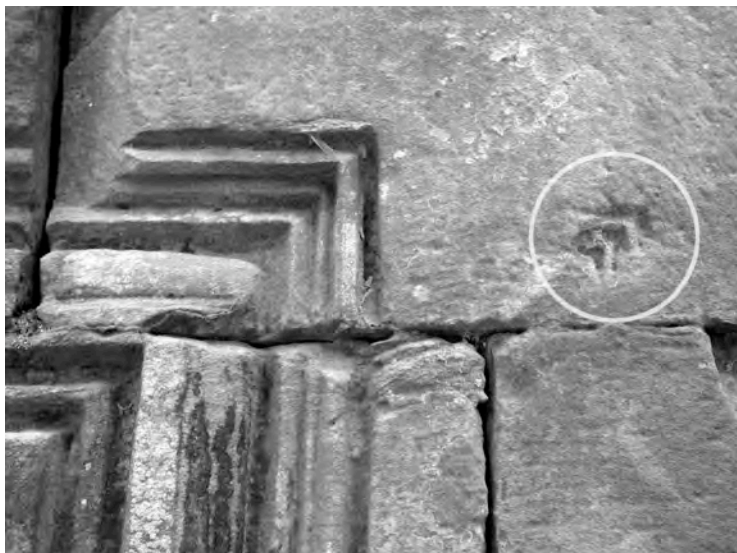
Ph. 702 : Détail de l'ébauche d'une première fausse-fenêtre à la face Nord de l'édifice TP.48 à Ta Prohm
