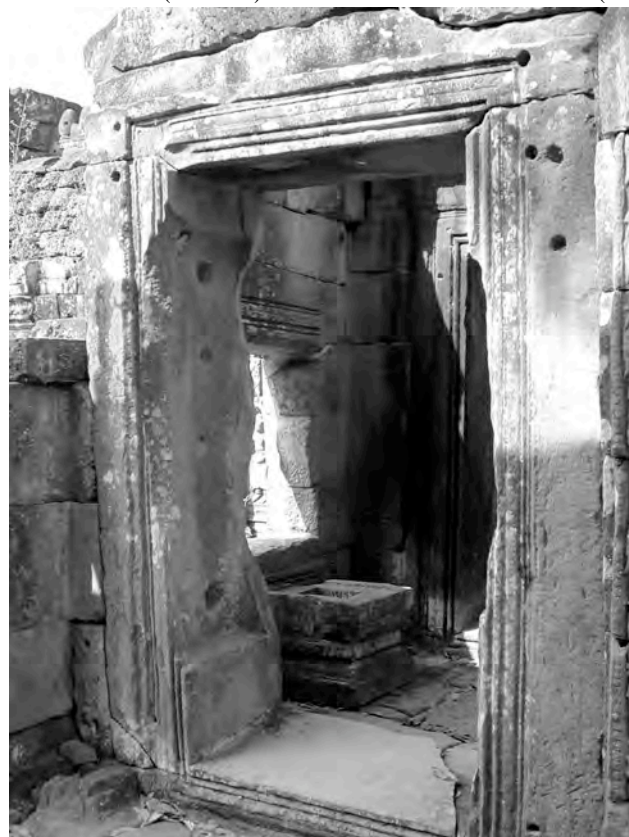
Ph. 759 : Piédroit Sud de la porte de l'avant-corps oriental du pavillon axial Est PK.140 du complexe Nord du Preah Khan d'Angkor
