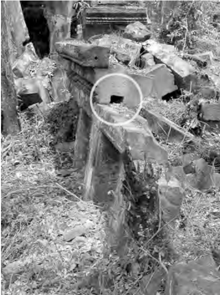
Ph. 974 : Logement de poutre dans la maçonnerie de la galerie Sud-Ouest PKKS.9 de la première enceinte du complexe central du Preah Khan de Kompong Svay
