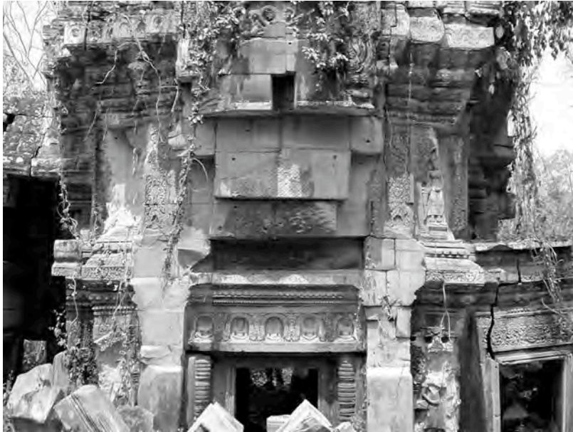
Ph. 566 : Ruine de l'avant-corps Sud du pavillon d'entrée PKKS.12 de la première enceinte du Preah Khan de Kompong Svay suite à l'extraction de ses sculptures ornementales
