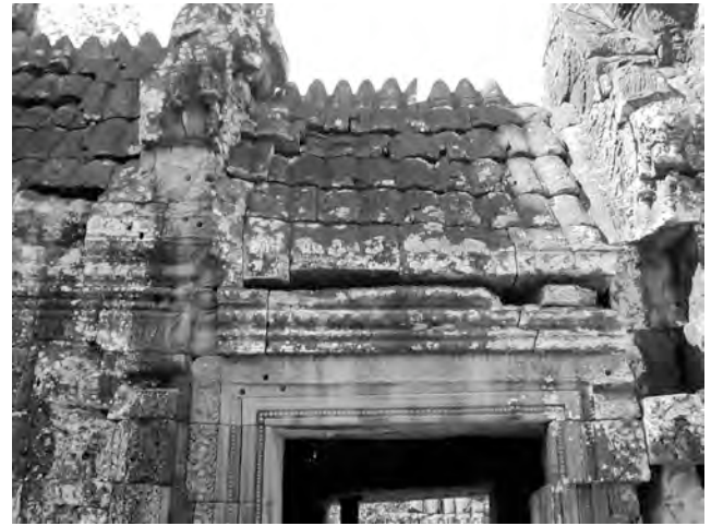
Ph. 244 : Superstructure du double vestibule BK.4-12 reliant le sanctuaire central BK.1 au pavillon d'entrée Nord BK.26 de la première enceinte
