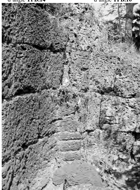
Ph. 919 : Vestige de pilastre d'angle au pavillon d'angle Nord-Ouest TPB.20 de la première enceinte de Ta Prohm de Bati
