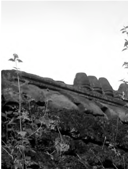
Ph. 634 : Faitage de type 3 en deux parties sans assemblage à la première enceinte du Preah Khan d'Angkor
