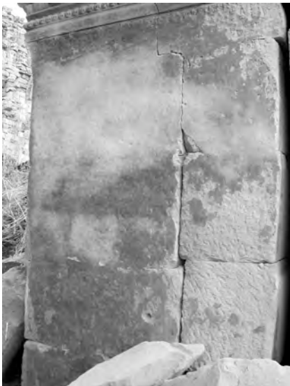
Ph. 988 : Vestige d'enduit à l'intérieur de la tour Nord de Banteay Tiep
