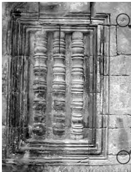
Ph. 701 : Fausse-fenêtre à faux-balustres avec ébauche d'une première fenêtre fictive à la face Nord de l'édifice TP.48 à Ta Prohm
