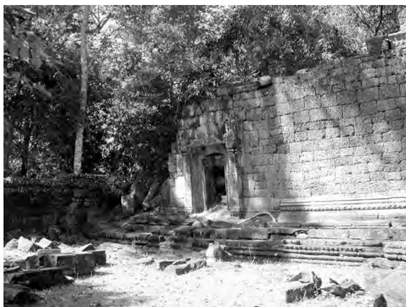
Ph. 103 : Entrée latérale Sud du pavillon d'entrée occidental TP.211 de la quatrième enceinte de Ta Prohm
