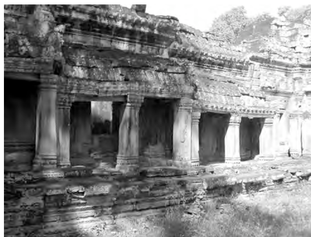
Ph. 290 : Galerie PK.165 reliant les avant-corps de pavillon central PK.148 et latéral PK.164 de l'entrée orientale de l'enceinte du temple
