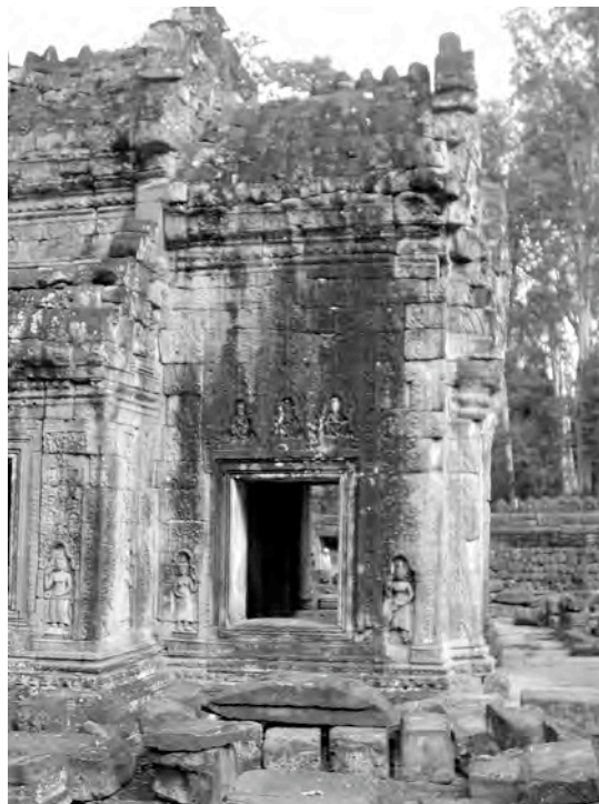
Ph. 298 : Avant-corps oriental du pavillon d'entrée occidental PK.157 de l'enceinte du temple
