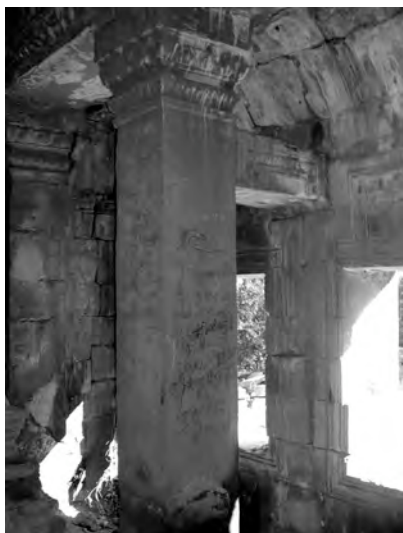
Ph. 793 : Étrésillons au Pavillon d'entrée Est TP.210 de la quatrième enceinte de Ta Prohm
