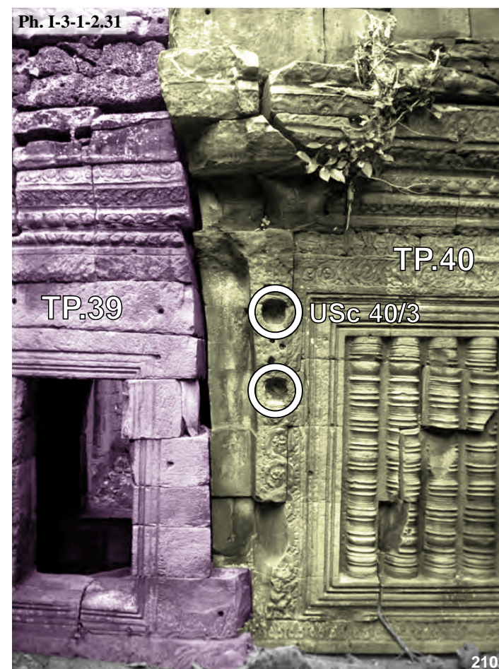
Ta Prohm, connexion entre l'avant-corps Ouest de la tour TP.40 avec le cloître Est, face Sud : USc 40/3
