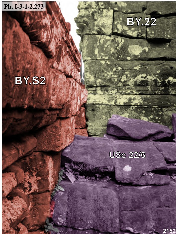
Bayon, connexion entre l'avant-corps Ouest de la tour BY.22 de l'enceinte intérieure et le soubassement du troisième étage
