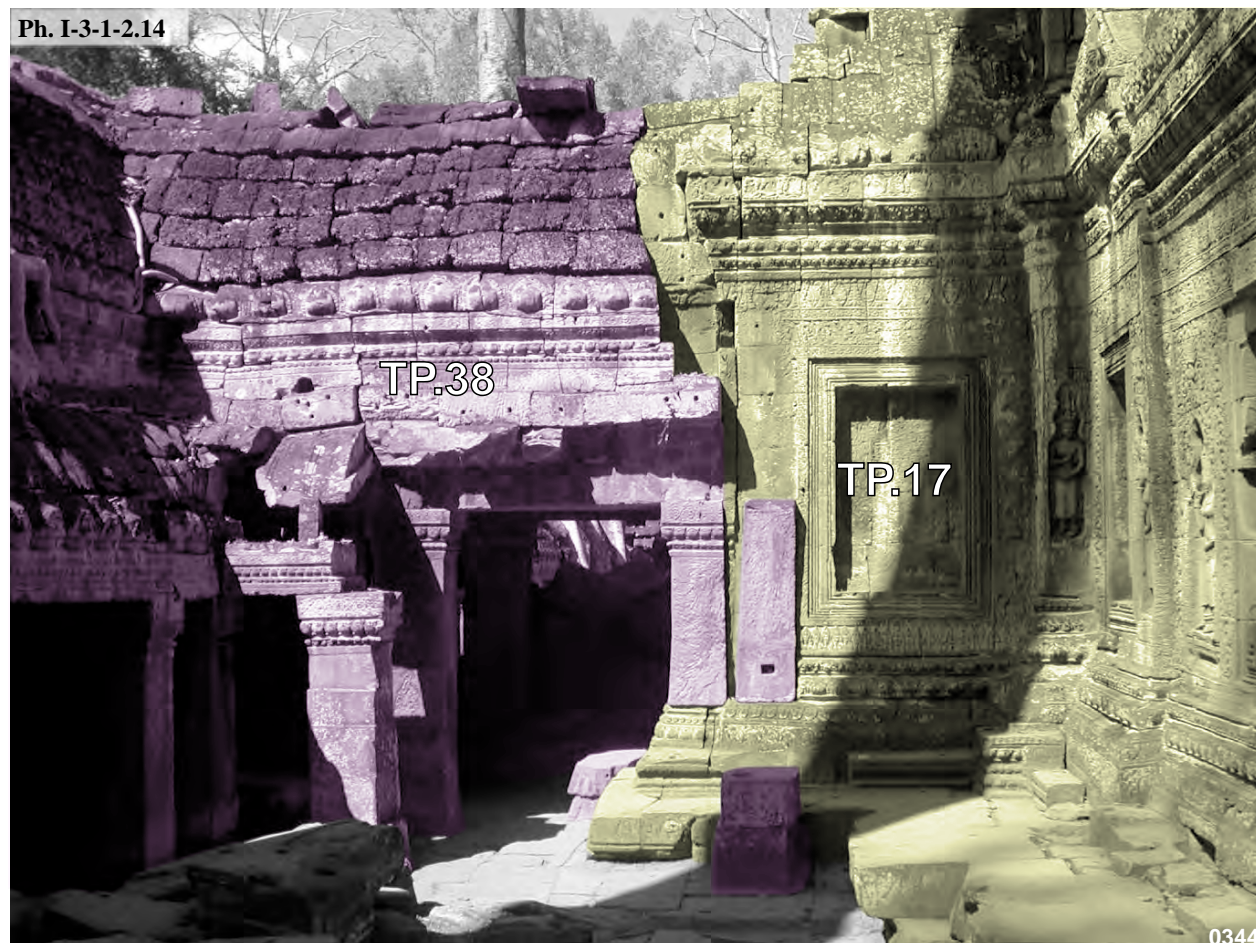
Ta Prohm, connexion entre le bras Ouest de la tour axiale Ouest TP.17 de la première enceinte avec la seconde galerie-enceinte, face Sud
