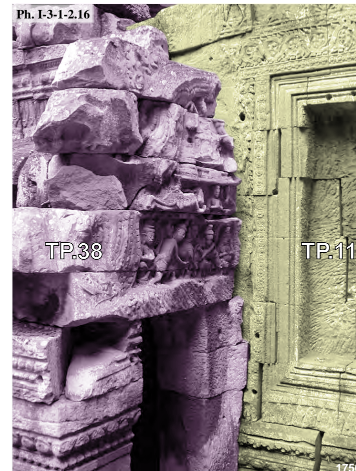
Ta Prohm, connexion entre le bras Sud de la tour axiale Sud TP.11 de la première enceinte avec la seconde galerie-enceinte, face Est
