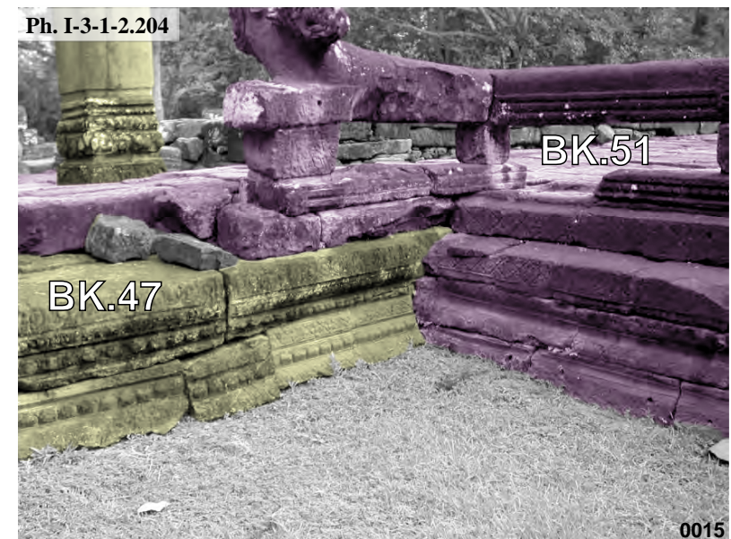
Banteay Kdei, connexion entre le soubassement du pavillon d'entrée Est BK.47 de la troisième enceinte et la terrasse cruciforme BK.51
