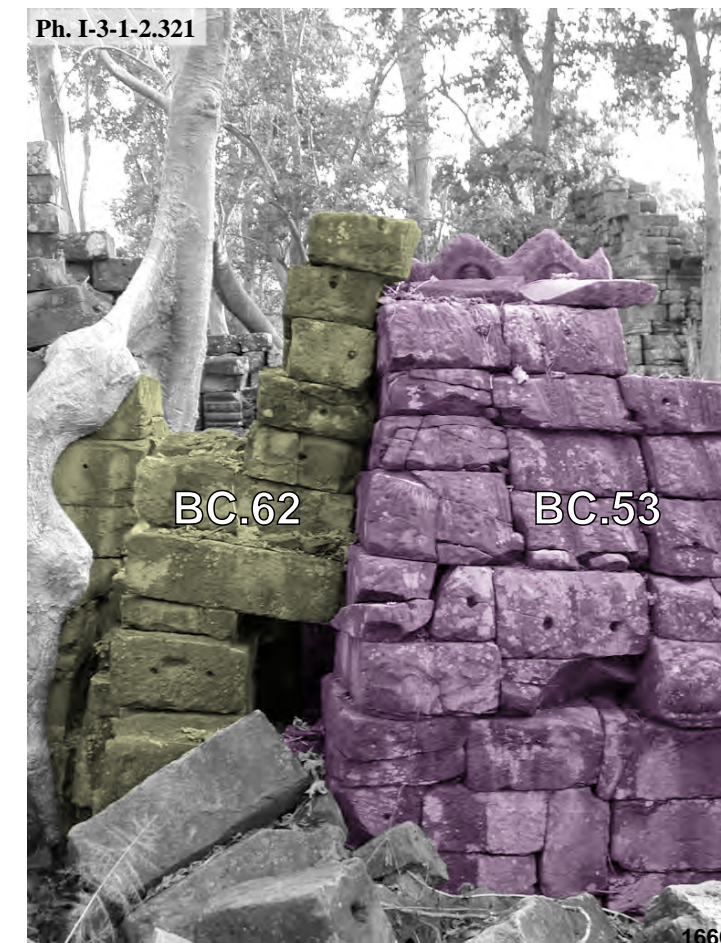
Banteay Chmar, connexion entre les vestige du bas Ouest l'édifice BC.62 de l'enceinte du complexe Est et son avant-corps Ouest BC.53 , face Nord
