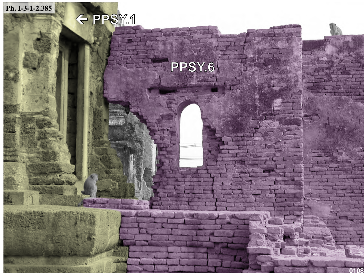
Phra Prang Sam Yod, avant-corps Est de la tour centrale PPSY.1 et extrémité Ouest du vihara PPSY.6
