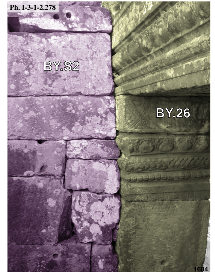
Bayon, détail de liaison porche de l'avant-corps Nord de la tour BY.26 avec le soubassement du troisième
