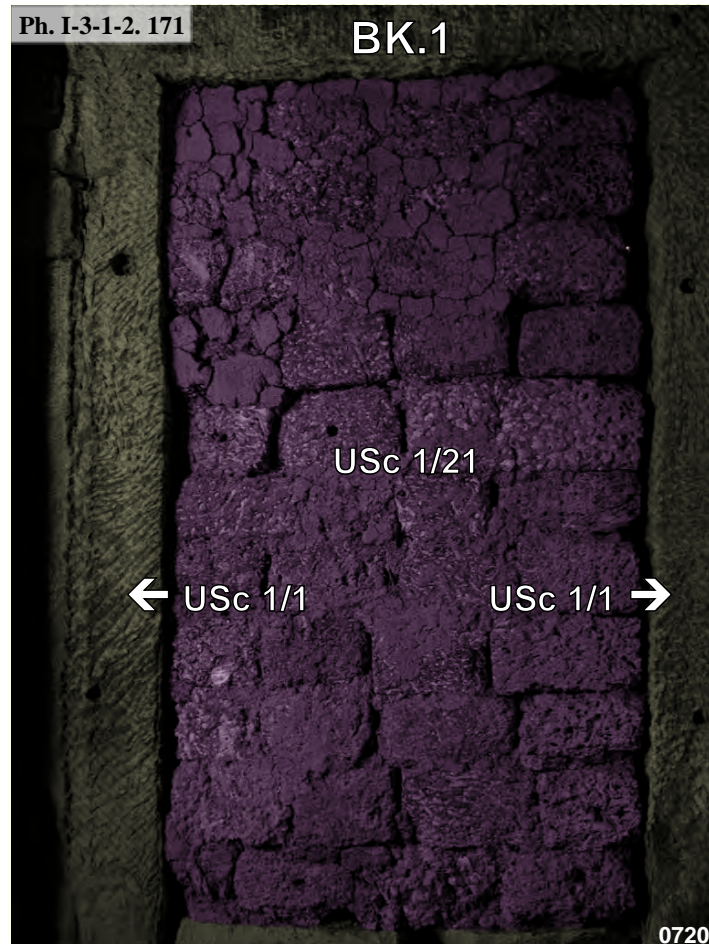
Banteay Kdei, porte Sud du sanctuaire central BK.1 , vue intérieure : USc 1/2 et USc 1/21
