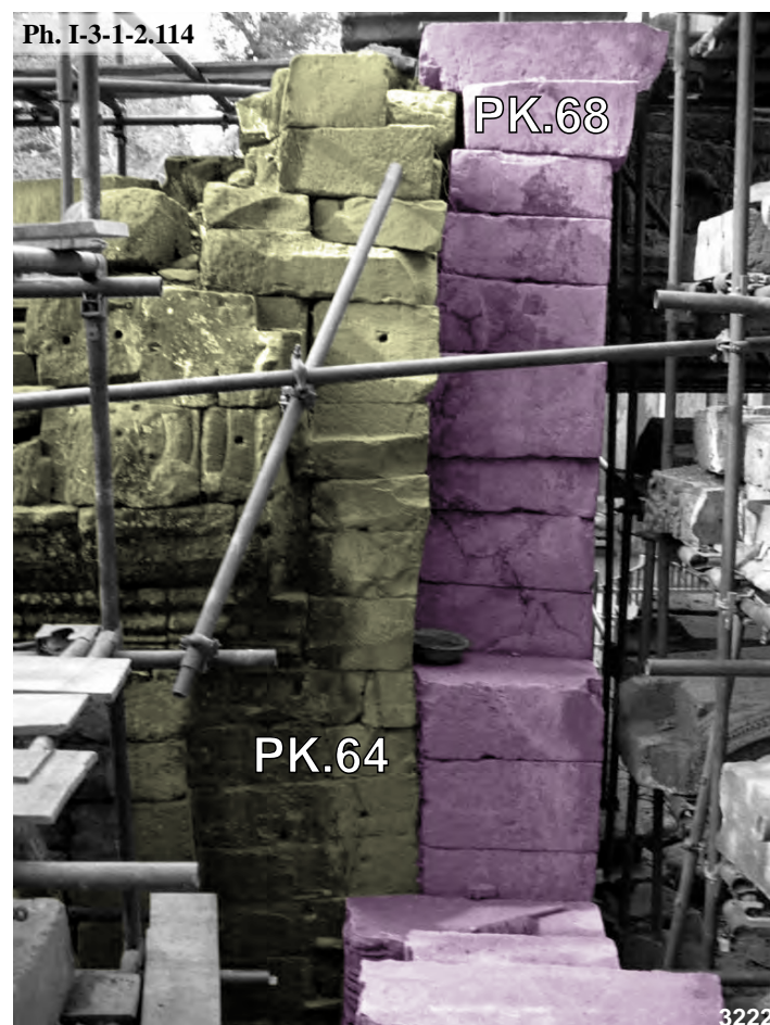
Preah Khan, connexion entre la bibliothèque Sud PK.64 et la salle aux danseuses, vue durant restauration du WMF
