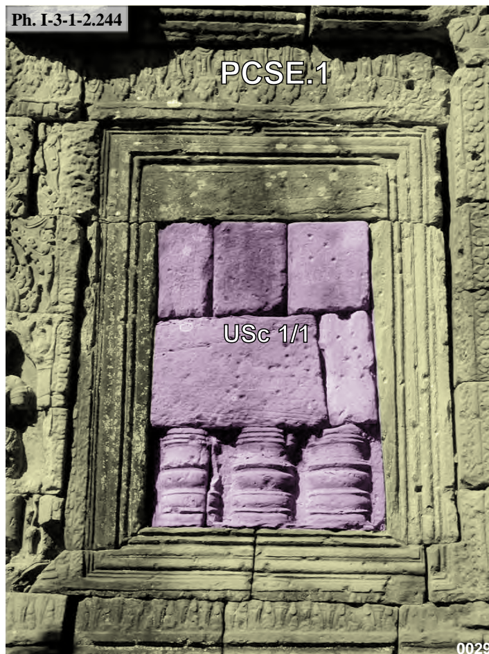
Prasat Chrung Sud-Est d'Angkor Thom, avant-corps Sud du sanctuaire central PCSE.1 face Est : USc 1/1
