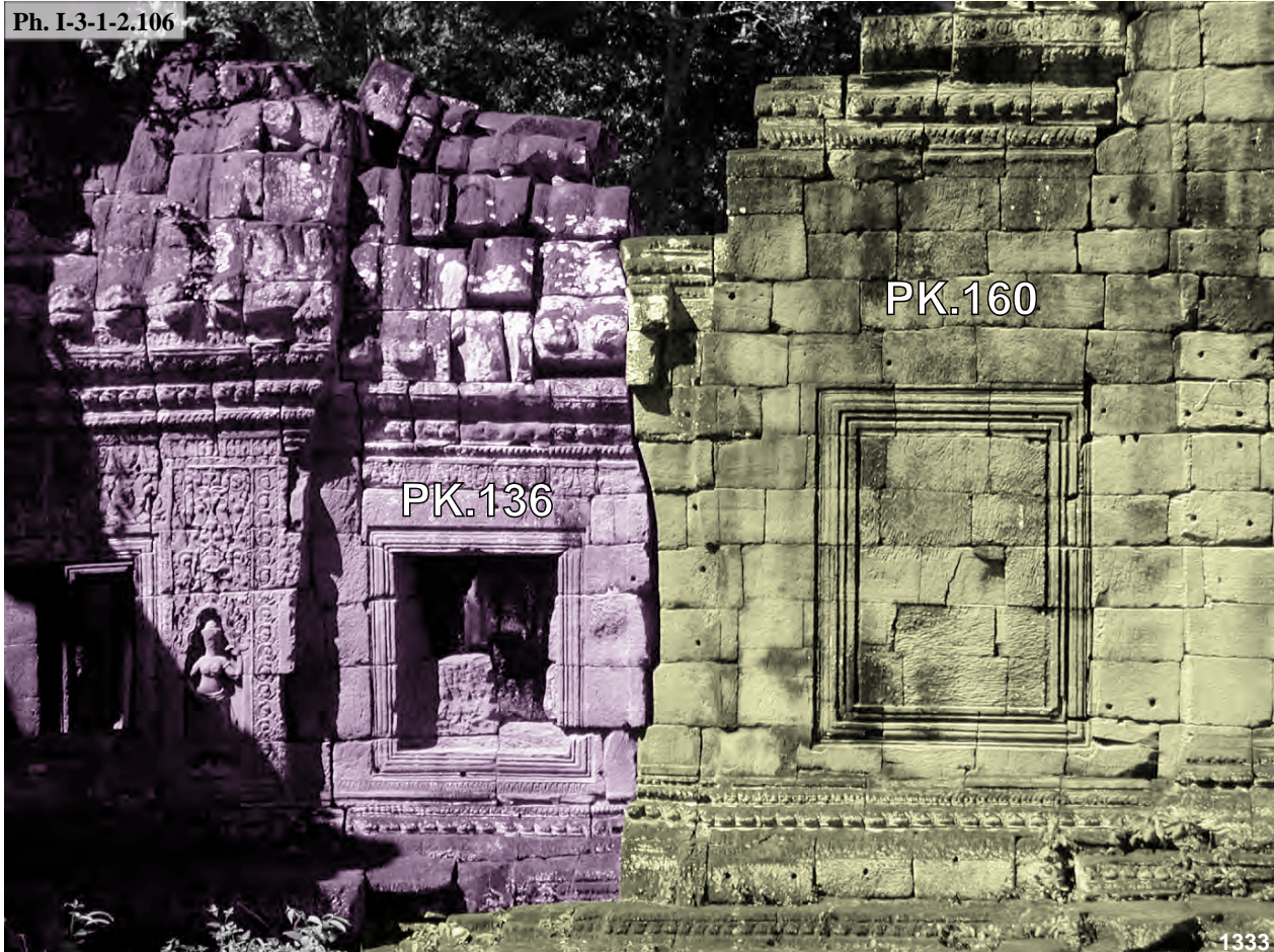
Preah Khan, connexion entre l'avant-corps de la tour axiale Nord PK.136 de l'enceinte du complexe Nord et l'avant-corps Sud du pavillon axiale Nord PK.160 de la troisième enceinte
