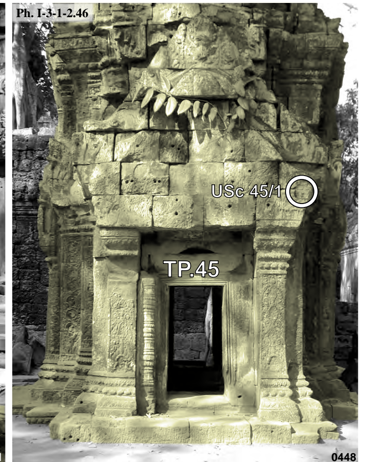
Ta Prohm, face Est de la tour TP.45 : USc 45/1
