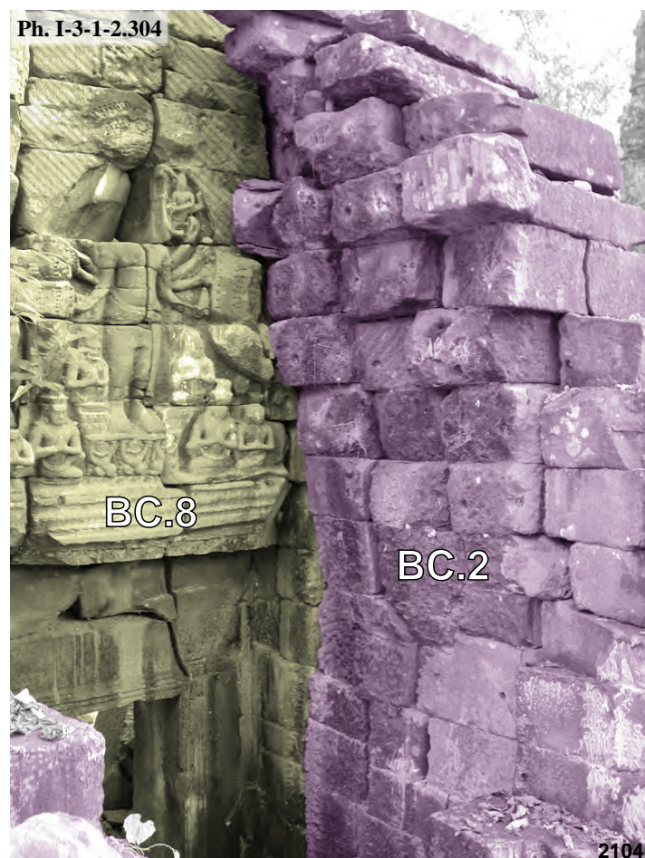
Banteay Chmar, fronton Ouest de la tour BC.2 et avant-corps Ouest BC.8 de cette même tour, mur intérieur Sud
