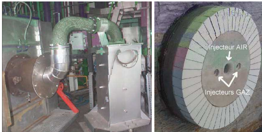
Figure 2.12 – (a) Réchauffeur d'air alimentant le brûleur NFK HRS. (b) Face avant du brûleur.
