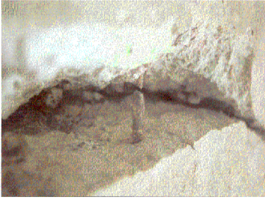
FIG. 1.1 – Dégradation locale de l'alcali-réaction (LCPC 1999)
