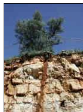
Fissures dans les couches calcaires (Nahr Beyrouth)
