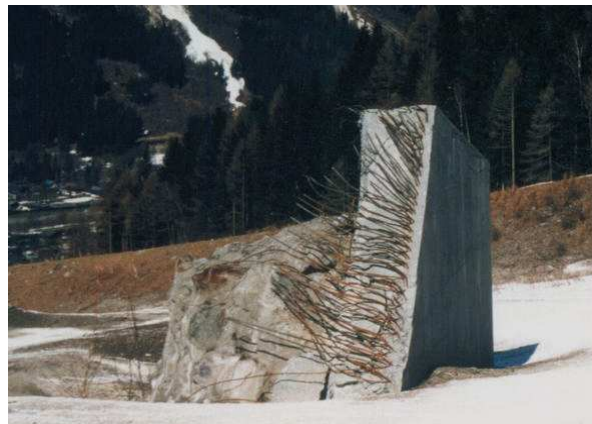
Photo 1.5: - Dent déflectrice endommagée - Taconnaz (Haute-Savoie) (photo C. Ancy)
