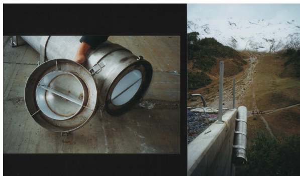
FIG. C.2: Photographie du dispositif en place sur le bunker et du mécanisme du fond amovible.
